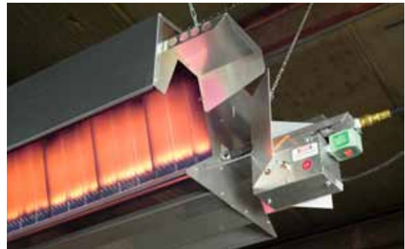
La unidad tiene un control electrónico de zona (chispa directa) de alta presión.
